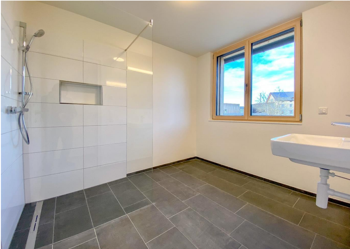
Badezimmer mit walk-in Dusche & Fenster
