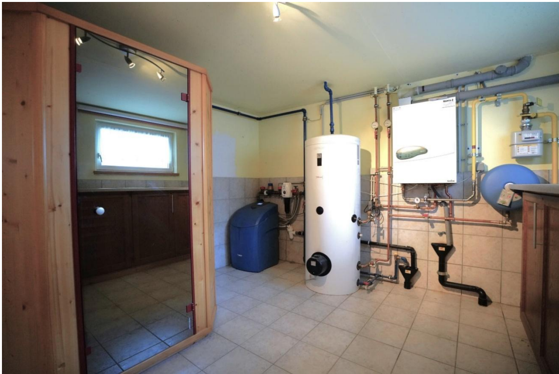
Technikraum mit Infrarotkabine
