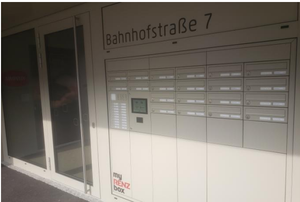
Eingangsbereich mit elektronischer Paketbox
