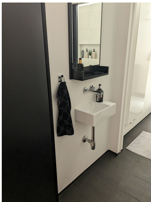
Zusätzlicher Handwaschplatz mit Spiegelschrank und Wandarmatur
